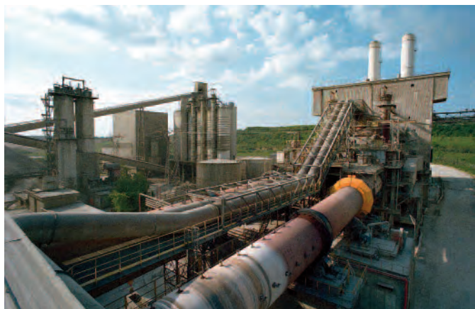
> Vue sur l'un des fours d'Airvault (four 4).
